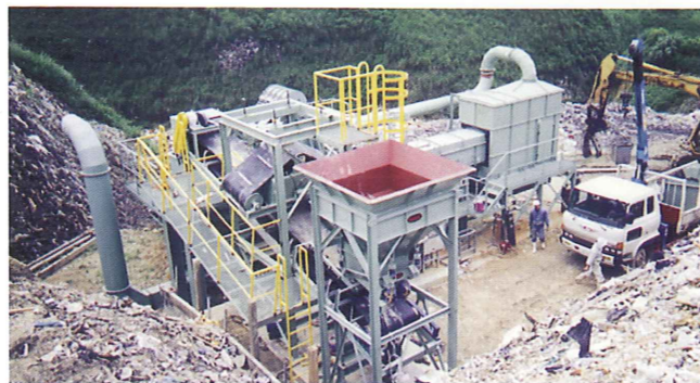
沖縄県 具志川市 M社 掘り起こしゴミ選別装置
