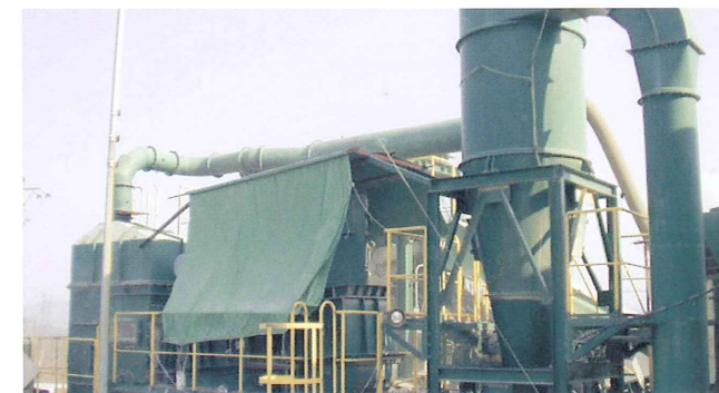
徳島県 徳島市 B社 建設廃材選別装置
