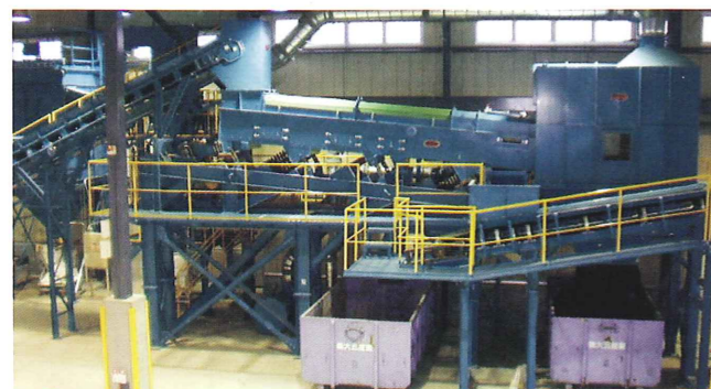
滋賀県 草津市 D社 混合廃棄物選別装置
