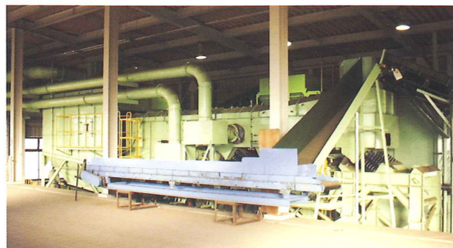
埼玉県 大宮市 T社 建設廃材選別装置
