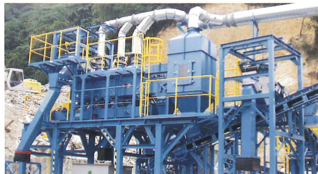
愛媛県 新居浜市 T社 建設廃材選別装置
