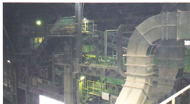
神奈川県 川崎市 T社 建設廃材選別装置
