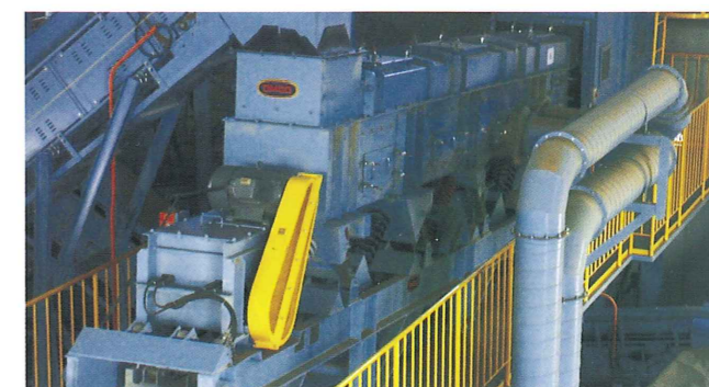
愛知県 豊田市 T社 混合廃棄物選別装置
