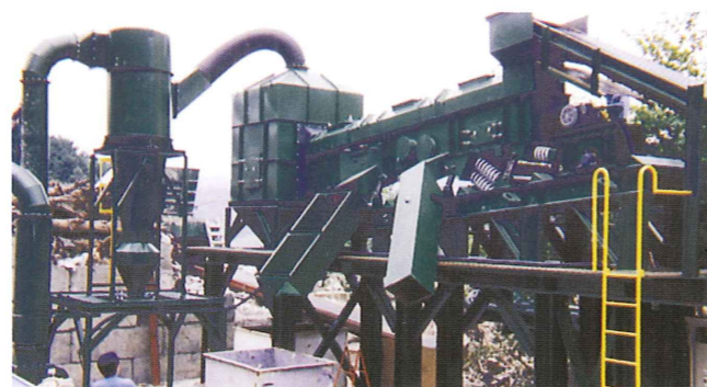
愛媛県 松山市 M社 建設廃材選別装置
