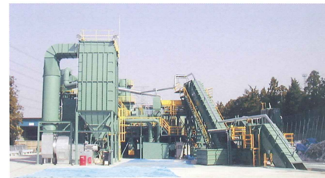
千葉県 白井市 I社 建設廃材選別装置
