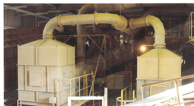
愛知県 大府市 D社 建設廃材選別装置
