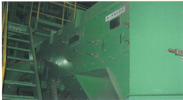
兵庫県 山崎町 R社 資源ごみ選別装置
