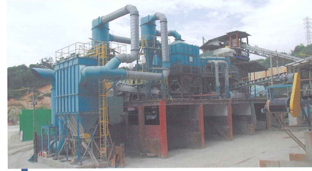
愛知県 美浜町 T社 建設廃材選別装置
