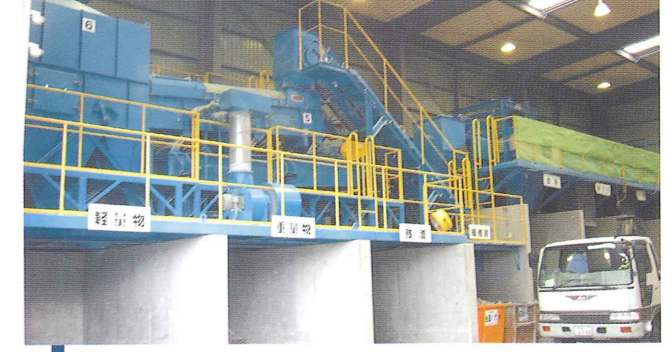
大阪府 高石市 F社 建設廃材選別装置
