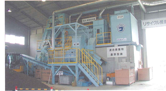
愛知県 豊橋市 M社 建設廃材選別装置
