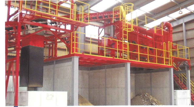
京都府 京都市 R社 建設廃材混合廃棄物選別装置
