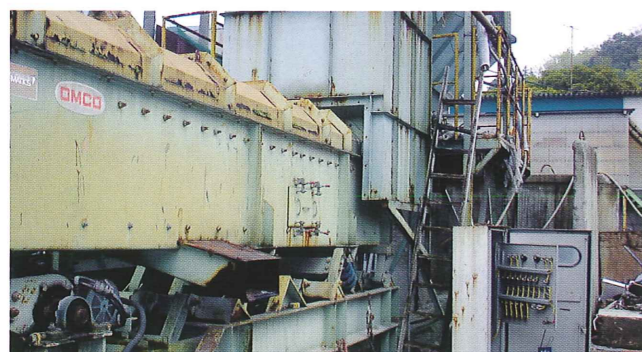
神奈川県 横浜市 K社 建設廃材選別装置
