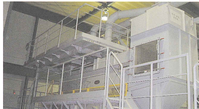
熊本県 水俣市 A社 廃家電選別装置
