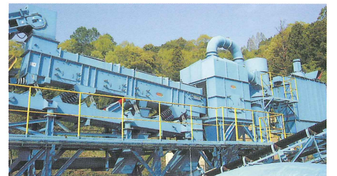
徳島県 徳島市 T社 建設廃材選別装置
